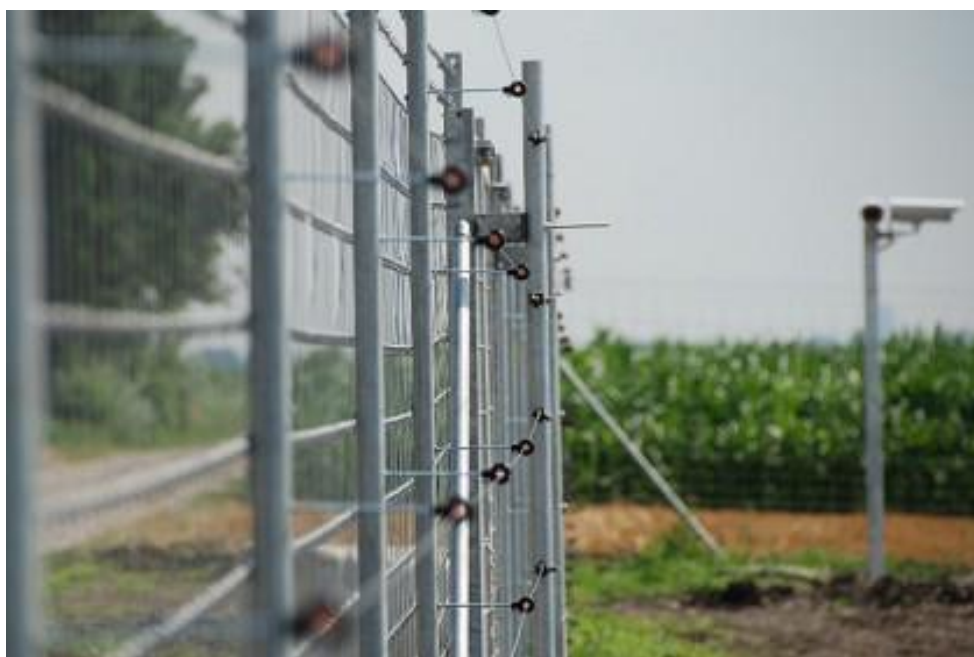
Rysunek 4 Przykładowe ogrodzenie farmy fotowoltaicznej
