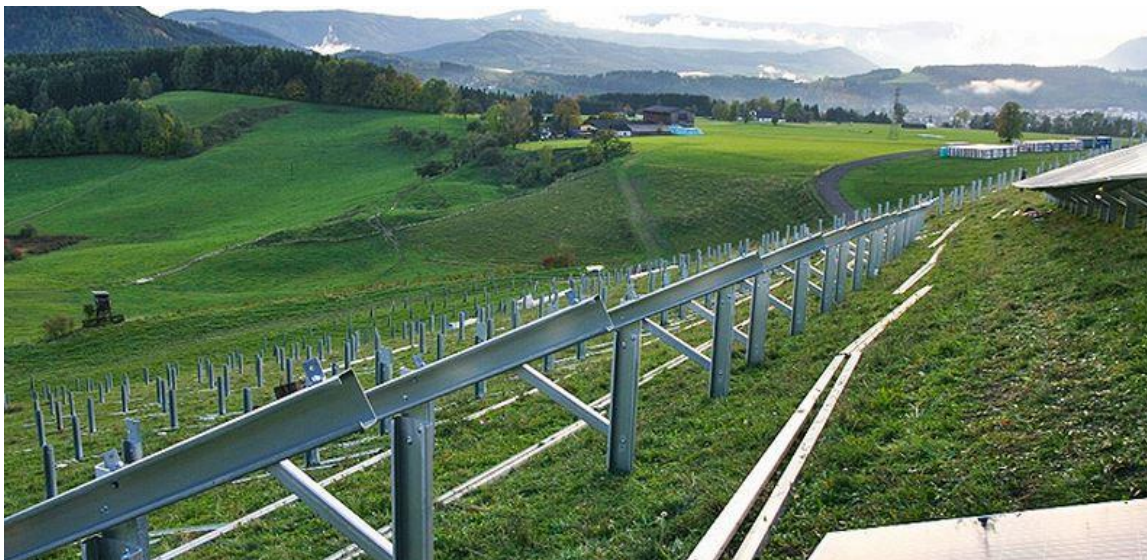
Zdjęcie 4 Konstrukcja przeznaczona do posadowienia paneli fotowoltaicznych.
